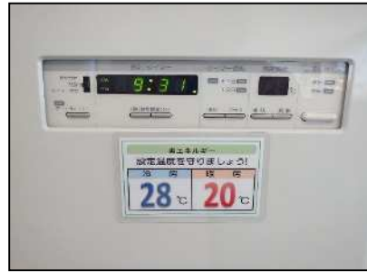
空調設備の温度調整
