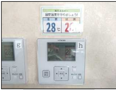
空調設備の温度調整
